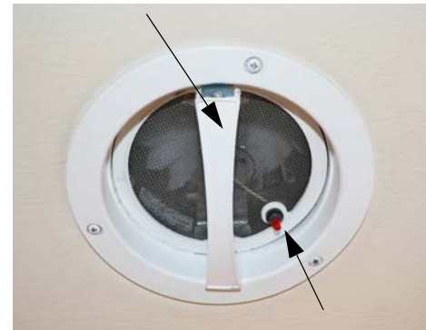
Fan Power Switch
