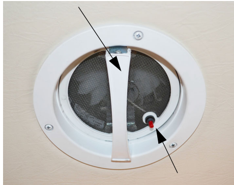
Fan Power Switch
