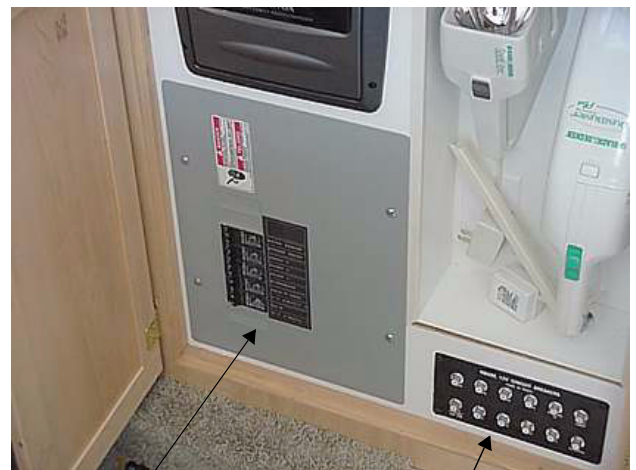
110-Volt AC Breakers
